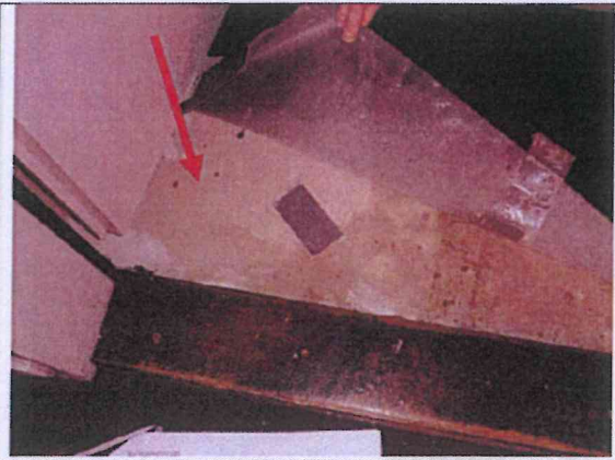
Foto 2: Keuken en hal bij toilet, Surinamestraat 75 Onderlaag Vloerzeil M2 - asbesthoudend
